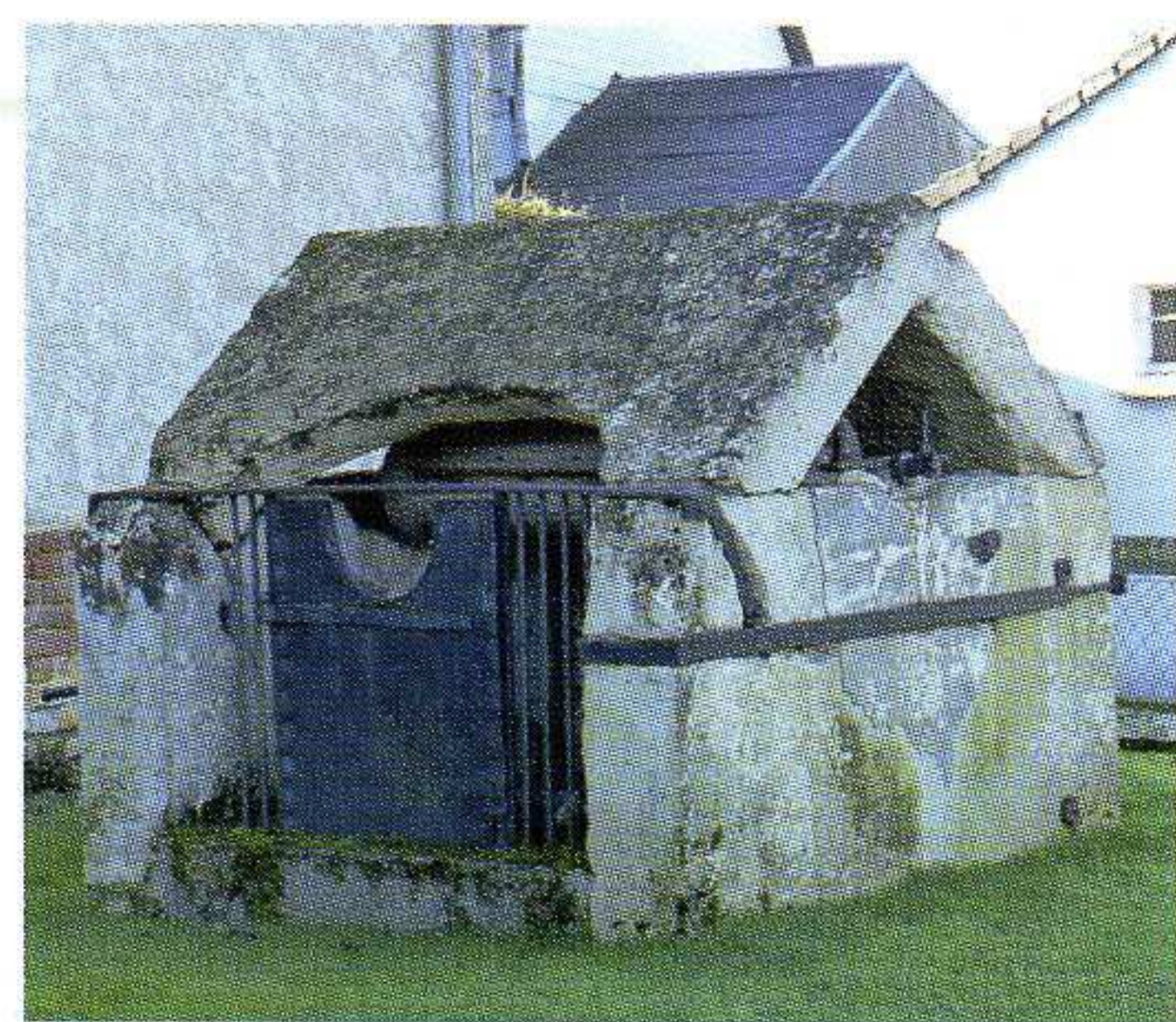
Ancien puits. Rotangy est située sur le Plateau picard, où de nombreuses éoliennes captent aujourd'hui l'énergie du vent
